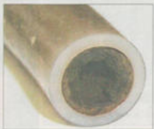
Typische Alterserscheinung: Rost und Schlamm verstopfen das Rohr. FOTO TGA
